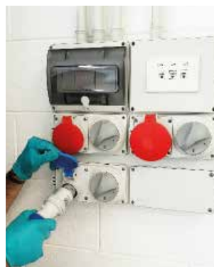
Collegare l'alimentazione elettrica motore monofase
