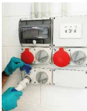
Collegare l'alimentazione elettrica motore monofase
