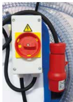
Quadro elettrico trifase
