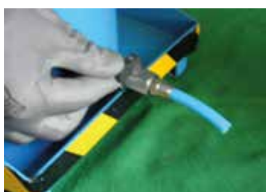
Valvola di scarico
